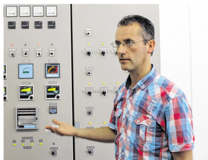
Olaf Beck gibt Erläuterungen im Wasserwerk.
